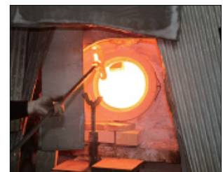
写真4 ガラス溶解炉
