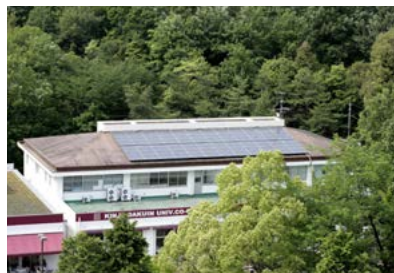
リリーイースト(食堂)屋上に設置した太陽光発電装置
